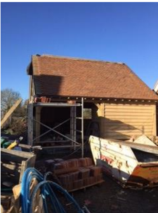
Inadequate edge protection
